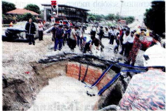
KESAN pancutan air daripada paip bawah tanah yang pecah mengakibatkan lubang besar di Jalan Universiti, semalam.
