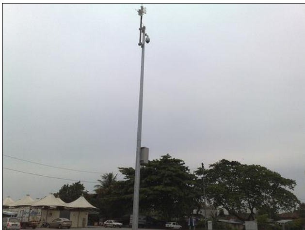
Foto 7: Peletakan CCTV di kawasan Perdagangan – Kuala Terengganu (Julai 2011)
