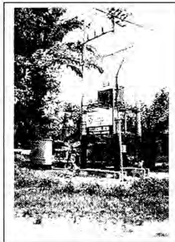
Penyediaan 'Substation' TNB Perlu Mengikut Piawaian
